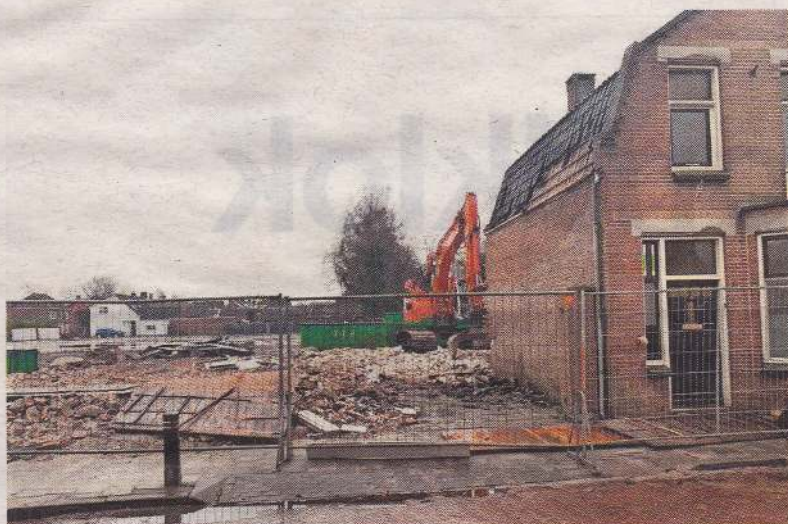
▲ Kelders en fundamenteën van de voormalige fabrieken worden verwijderd. Over enkele maanden start de bouw van Heerehoeve in centrumplan Gilze. FOTO ALPHONS COOLEN BOUW
